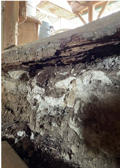
Poutre pourrie seuil Tennstor
