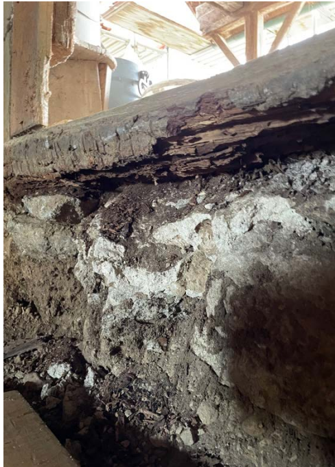
Verfallener Balken Schwelle Tennstor
