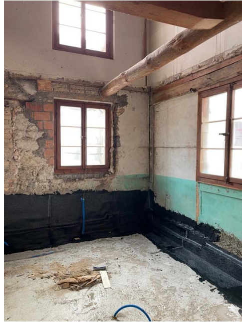
Betriebswohnung Ersatz Balkenlage
