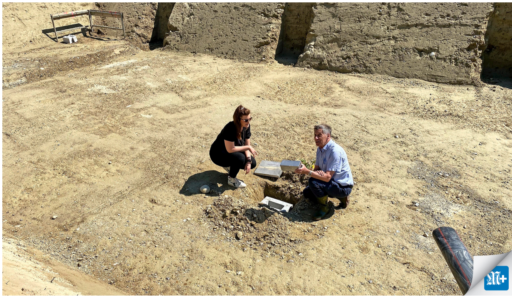
Die feierliche Grundsteinlegung: Bettina Lüdin und Matthias Brefin sind Nachfahren Albert Ankers.
